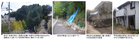
左半に校舎があり、道路の右側に位置する知恵のある山手と道路沿いに起っている長家が斜めに崩れている(1校) 校舎の東側に生じた地すべり 学校の中心部津波に襲った民家とその周辺部分の崩壊 学校近隣の用地に広がる山手はかなりの幅が認められる。
